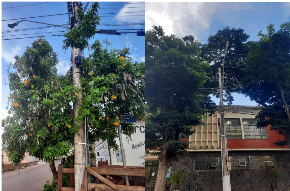
Figura 4 - Contato com rede elétrica
